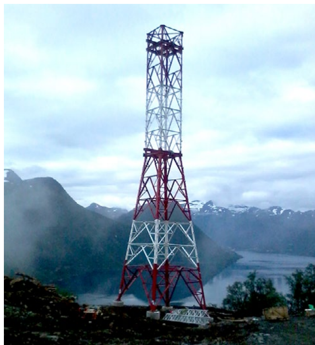
■ Sostegno a traliccio di Rebaioli lungo la linea 420 Kv Orskog-Fardal
